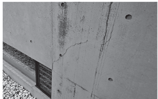
写真-5 外壁コンクリートのクラック
