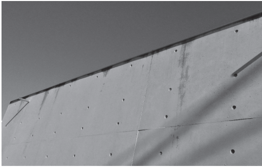
写真-2 外壁そのものの汚れ
