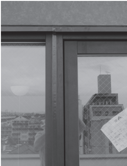
写真-30 スチール製建具のジョイント目地(1)
