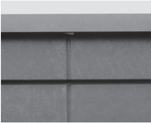
写真-29 屋上サカロックの版間目地のアップ
