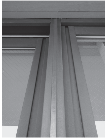
写真-31 スチール製建具のジョイント目地(2)
